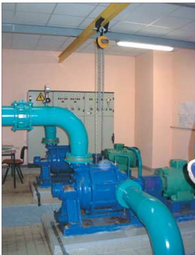
Photo 2 Rail de manutention avec chariot et palan au-dessus des pompes de distribution.
