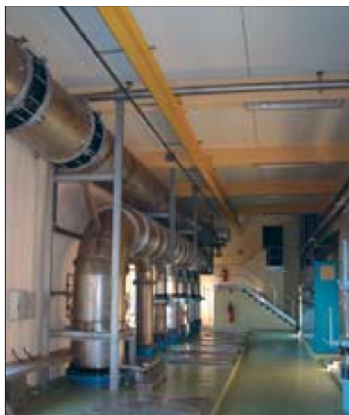
Photo 6 Rail de manutention placé au-dessus des trappes donnant accès aux pompes immergées.
