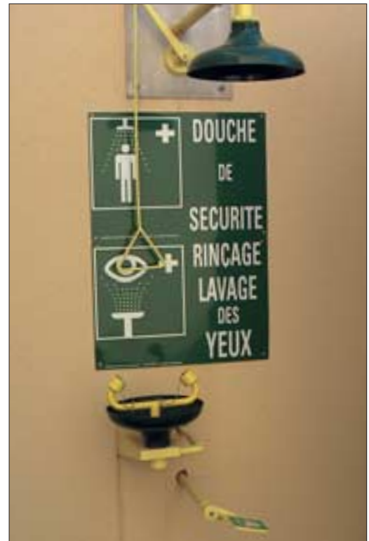
Photo 3 Douche de sécurité et lave-œil.
