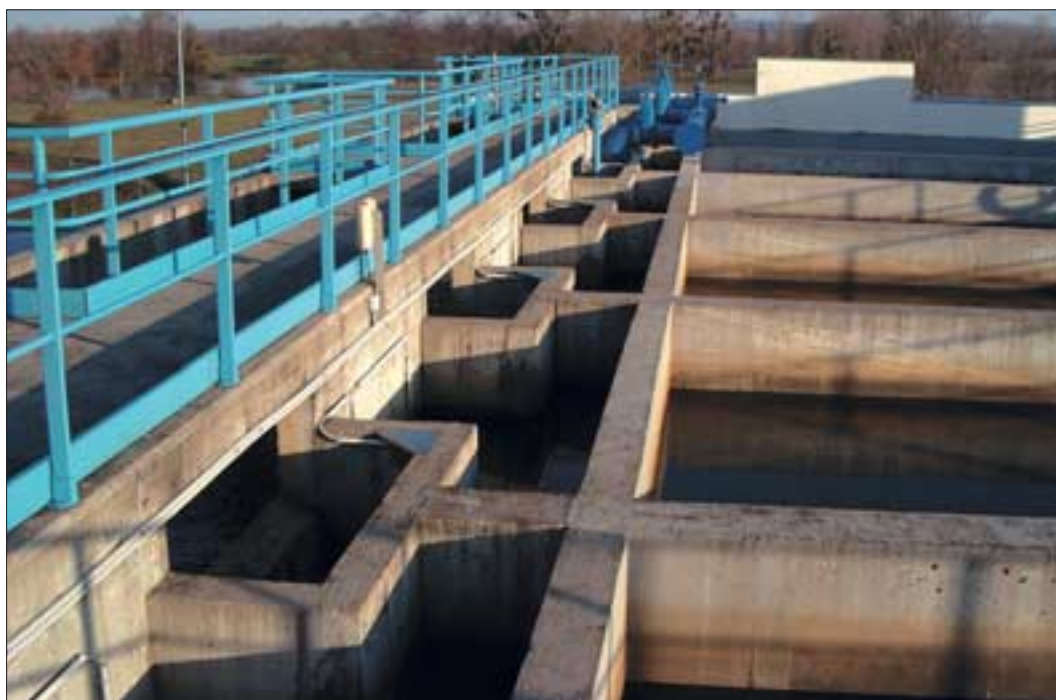
Photo 7 Vue d'un filtre à sable.
