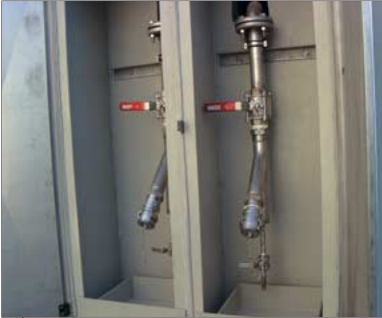
Photo 9 Dispositif de dépotage avec rétention.
