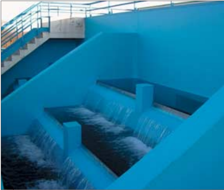
Photo 8 Cascade d'eau potable avant distribution dans le réseau.
