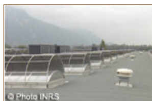
Exemple de protections solaires par l'extérieur en toiture + groupe de rafraîchissement d'air (caissons noirs)
