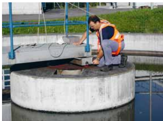
Figura 43 Al di là del parapetto l'operatore è protetto da una fune di sicurezza.
