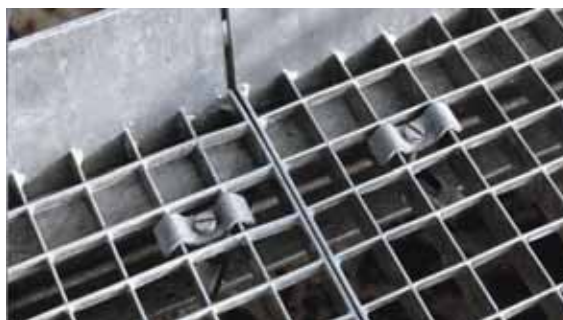
Figura 15 Ogni elemento della griglia metallica è saldamente fissato e non può essere accidentalmente spostato.
