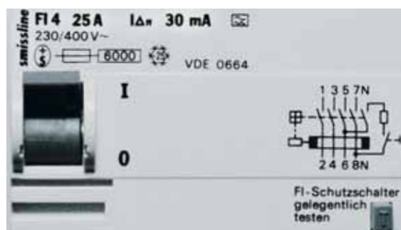
Figura 38 Interruttore protettivo a corrente di guasto. Si veda la pubblicazione della Suva «La connessione protettiva a corrente accidentale» (codice SBA 103).
