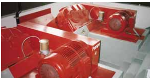
Figura 1 Questa installazione tecnica non costituisce più una fonte di pericolo. Tutti gli elementi in moto sono stati rivestiti.
