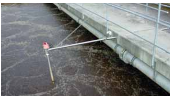
Figura 47 Un paranco consente di spostare le sonde di misurazione verso il bordo del bacino di aerazione; in questo modo la manutenzione avviene senza rischi.
