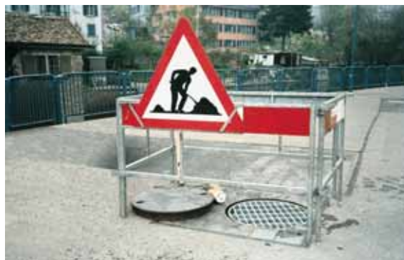
Figura 48 Questo tombino è protetto da una transenna mobile, la quale è stata giustamente posizionata prima di rimuovere la griglia.
