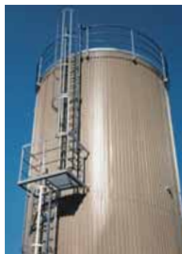
Figura 23 Scala fissa a pioli con gabbia di protezione. Lungo il perimetro del tetto, in corrispondenza della zona di accesso, è montato un parapetto di protezione.
