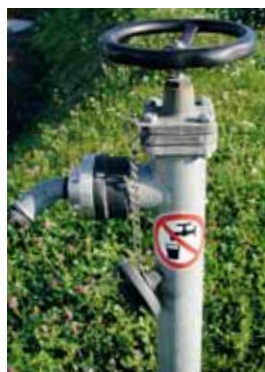
Figura 44 Le prese d'acqua che forniscono acqua non potabile devono essere adeguatamente contrassegnate.
