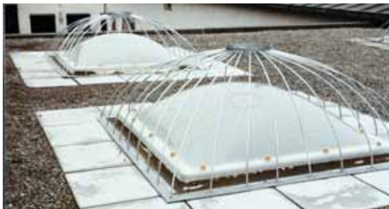
Figura 26 La superficie del lucernario non è portante; un'intelaiatura in metallo impedisce che possa essere sfondata.
