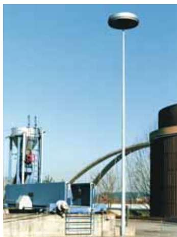
Figura 32 Una buona illuminazione artificiale consente di eseguire i lavori necessari (ad esempio in caso di guasto) anche durante la notte.
