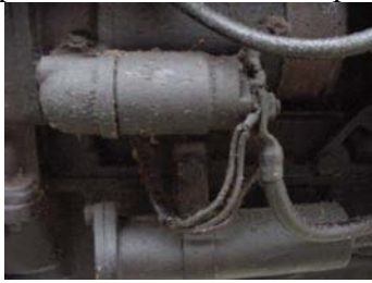
Esempio di cavi non protetti
