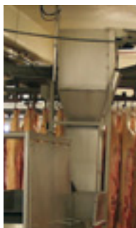
Goulotte en inox avant traitement
