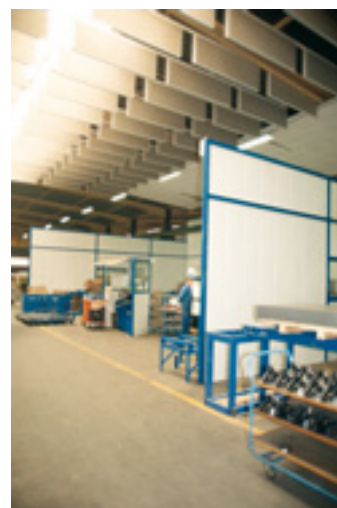
Écrans de séparation des postes
