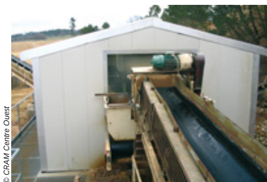
Alimentation de la cabine par bandes transporteuses
