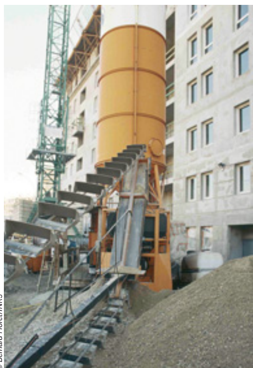
Nouvelle centrale à béton
