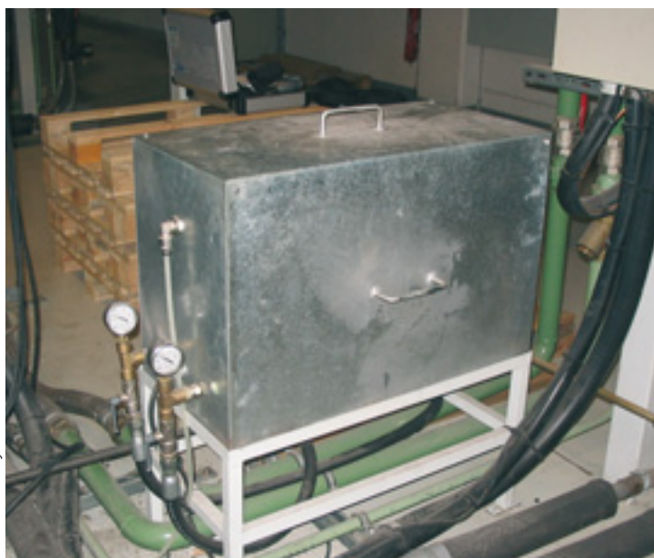
Encoffrement du compresseur
