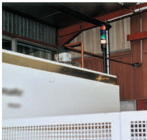
Machine avec la sortie d'air épuré raccordée sur l'extérieur
