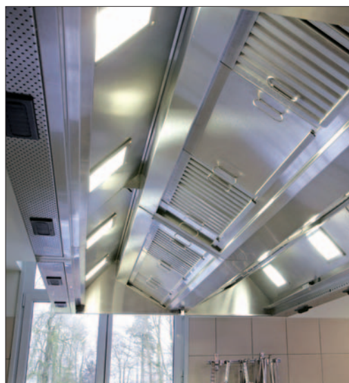
Hotte avec filtre à graisse, éclairage et gouttière de récupération des buées.
