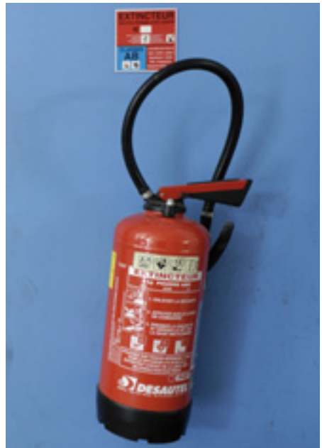
6. Extincteur en permanence à son emplacement, accessible et bien signalé
