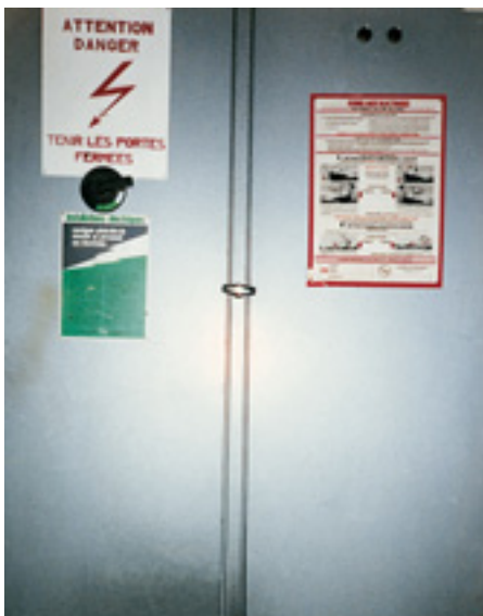
7. Armoire électrique avec affiches et interrupteur rapidement et facilement accessible permettant la mise hors tension de l'installation électrique
