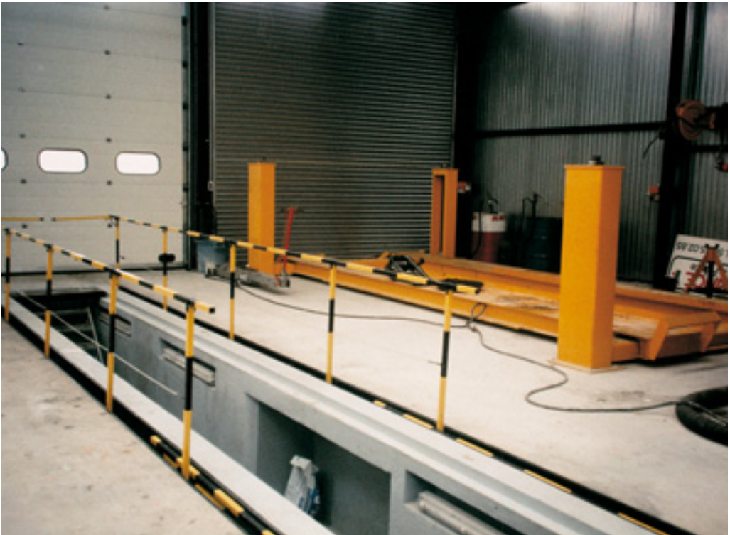
32. Fosse de visite équipée d'une barrière de protection escamotable
