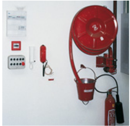
5. Poste "sécurité incendie" avec notamment RIA et extincteur bien repérés
