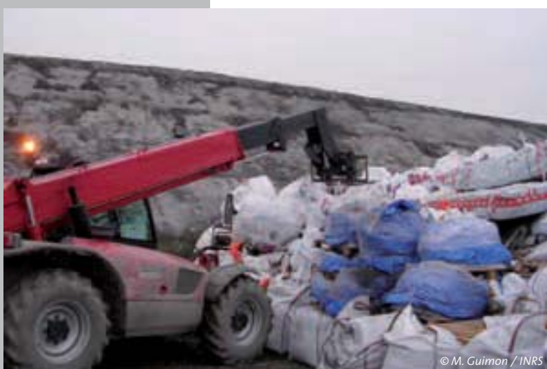
Dépose d'un GRV dans une alvéole
