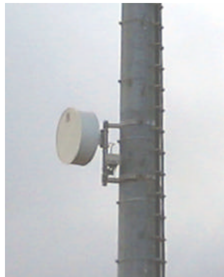
PONTE RADIO SISTEMA DIRETTIVO (ALTA FREQUENZA)
